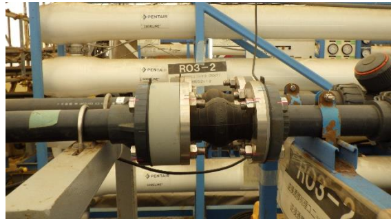
(写真3-2) 漏えい箇所2（配管フランジ部）の状況 （今回撮影：令和5年6月1日）
