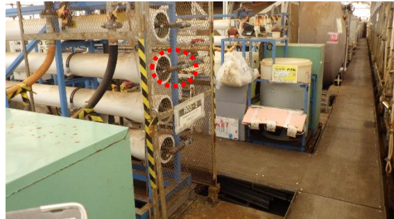
(写真2-2) 漏えい箇所1（逆浸透膜出口配管）の状況 （今回撮影：令和5年6月1日）
