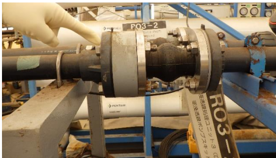
(写真3-1) 漏えい箇所2（配管フランジ部）の状況 （前回撮影：令和5年2月28日）
