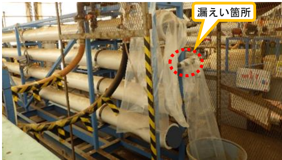
(写真2-1) 漏えい箇所1（逆浸透膜出口配管）の状況 （前回撮影：令和5年2月28日）
