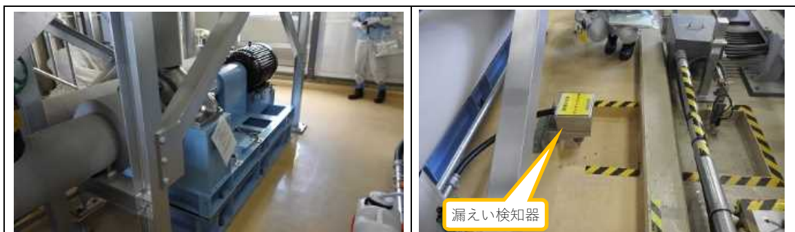
(写真1) 循環ポンプの設置状況
