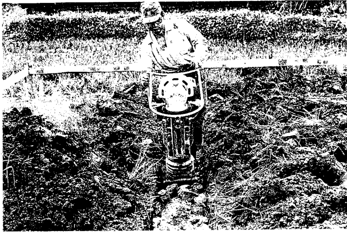
2—31 ランマーによる土突き作業 最近の土突きは、人手不足もあってランマー（土突機械）が登場し、家を建てる時の基礎作りで活躍している。
