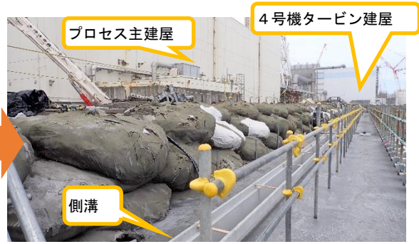
(写真3-2) 4号機南側におけるアウターライズ 津波防潮堤上部の状況（南東側から 令和5年5月25日撮影）
