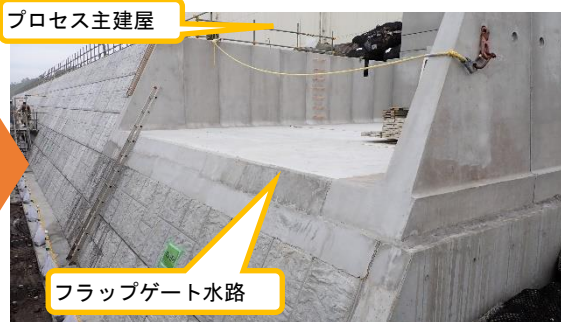
(写真1-2) 4号機南側における日本海溝津波防潮堤（アウターライズ津波防潮堤の法面補強）の状況（北東側から令和5年5月25日撮影）
