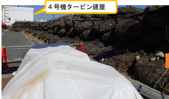
(写真2-1) 4号機南側における日本海溝津波防潮堤の防潮堤本体工事の状況（南西側から令和5年3月1日撮影）
