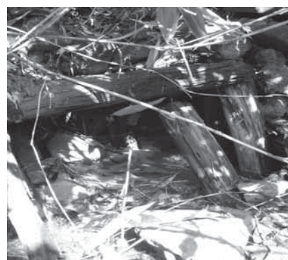
（写真5 アマ沢坑口の崩落）
