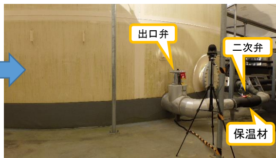
(写真 2-2) (令和 5 年 4 月 12 日撮影) N2 タンク 出口弁 保温材設置済
