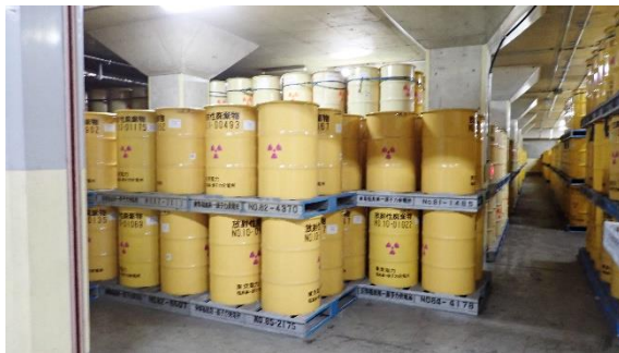
(写真1-3) 第6棟(南側)における廃棄物 保管の状況
