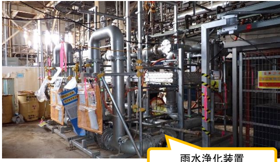
(写真1) 雨水浄化装置の状況 (1号Rw/B 西側)
