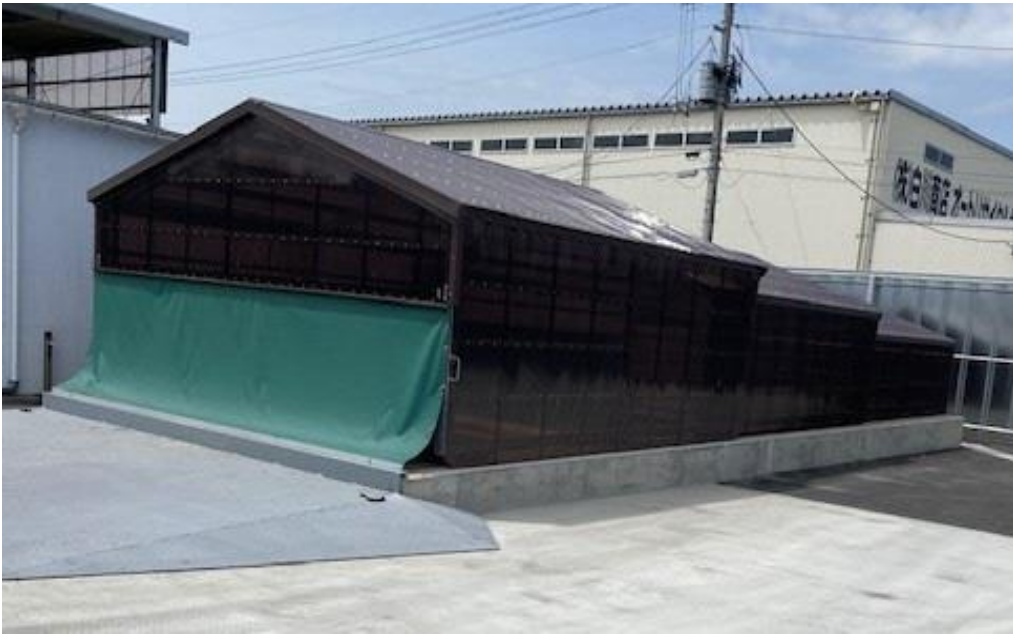
大型分離槽全景
