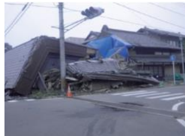
▲地震で倒壊した家屋（南相馬市）
