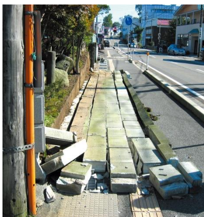
▲ブロック塀の倒壊
