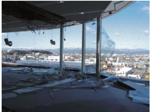
▲東日本大震災時にプレゼンテーションルーム、特別会議室のガラス壁面が崩落したビッグパレットふくしま
