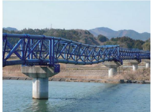
▲東日本大震災時にたわみが発生し架け替えが必要になった沼部水管橋（いわき市）
