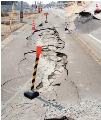
▲東日本大震災時に被災した下水管路施設（矢吹町）
