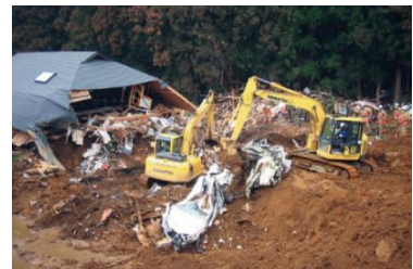
▲土砂崩れによる建物被害（白河市）
