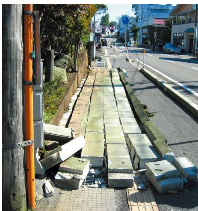
▲ブロック塀の倒壊
