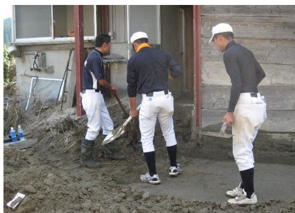
▲ ボランティア活動（泥かき）（只見町） 令和元年 10 月 12 日令和元年東日本台風
