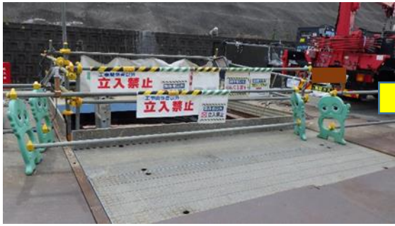
(写真 2 - 1) 発進立坑の状況① (前回(令和4年10月17日)北側から撮影)
