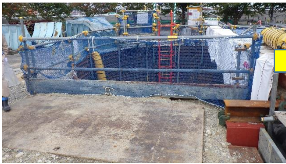
(写真 2 - 3) 到達立坑の状況① (前回(令和4年10月17日)南側から撮影)
