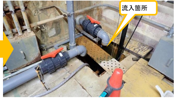
(写真 2-4) 地下水流入箇所の状況 (令和 5 年 1 月 19 日撮影)
