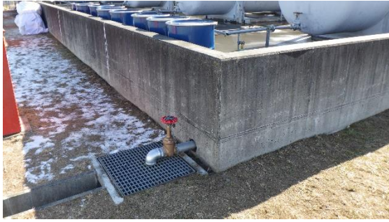
(写真1-3) 絶縁油タンクエリア（Dタンク エリア西側）の堰外の状況
