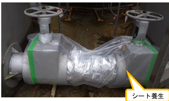
(写真3) 取り外しされていない連結管の例
