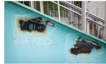
防食機能の劣化
