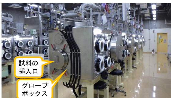
(写真 4 - 1) グローブボックス室内の状況
