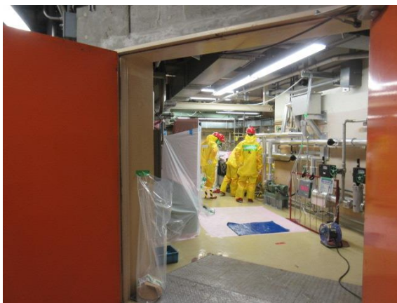
(写真1-1) 除染作業中のCRD補修室内の状況 (令和3年7月6日撮影)
