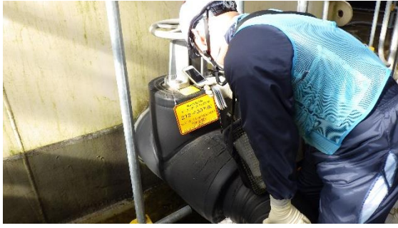
(写真6-2) スマートフォンを用いた出口弁の確認 状況
