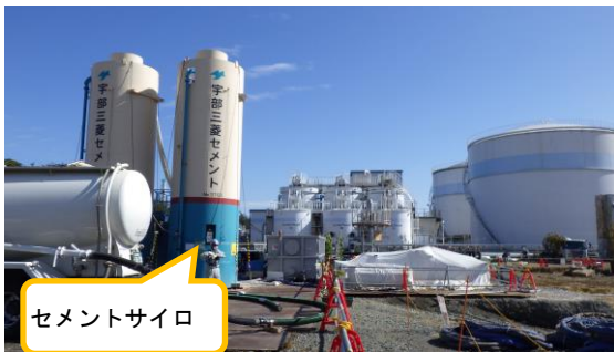
(写真 3) ・セメントを製造する設備 ・セメントサイロの裏にバッチャー プラントがある。 (エリア北部分を西側から撮影)
