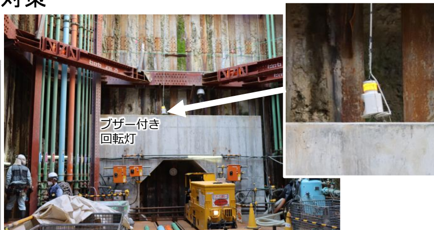
回転灯の設置状況
