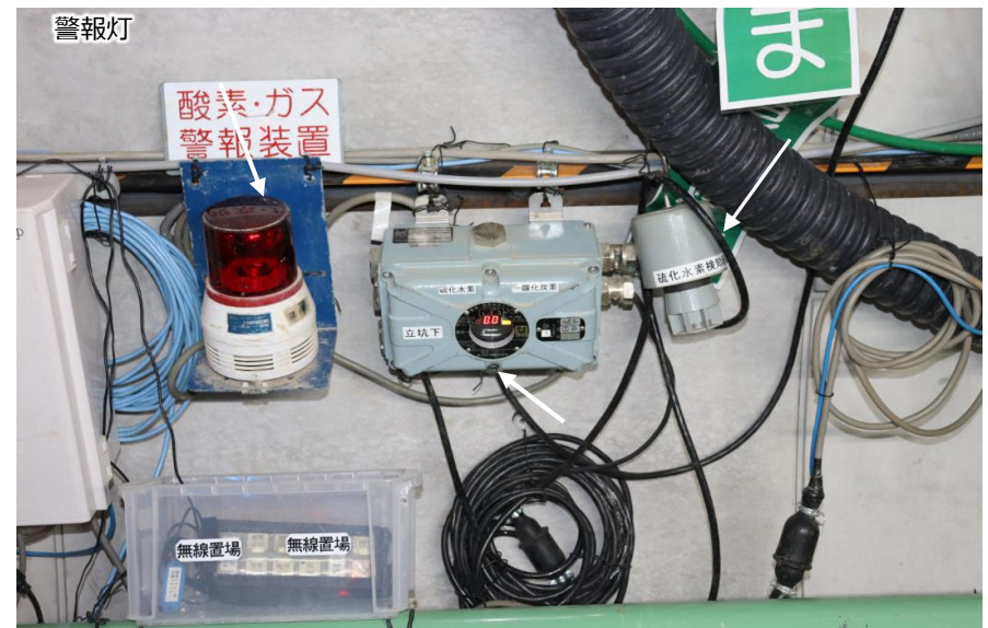
トンネル内のガス濃度検知機の設置状況
