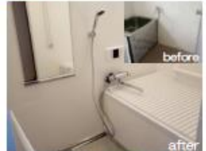
②浴室へユニットバス(シャワー付き混合水栓付き) ・手すり設置
