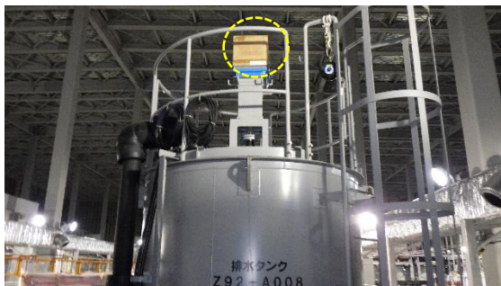
(写真3-1) 排水タンクに設置された代替フィルタの状況 (令和3年9月27日撮影)
