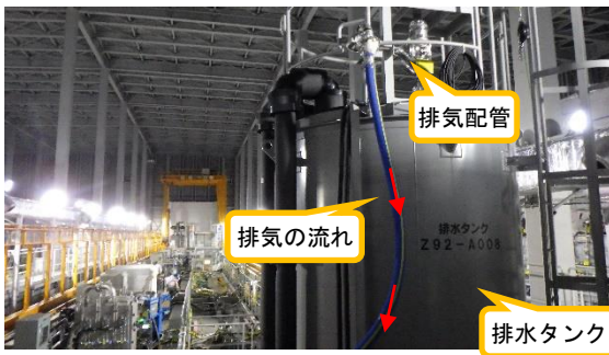
(写真 1 - 3) 排水タンクの排気ラインの状況①
