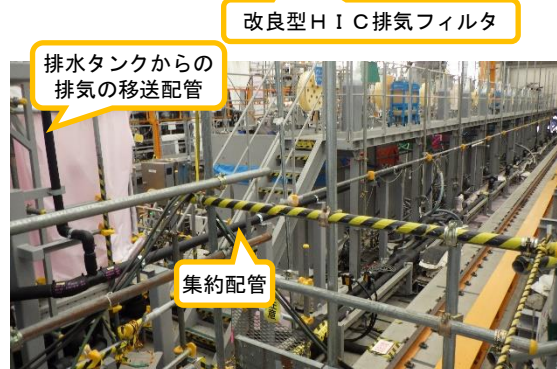
(写真4-2) 集約配管の状況①
