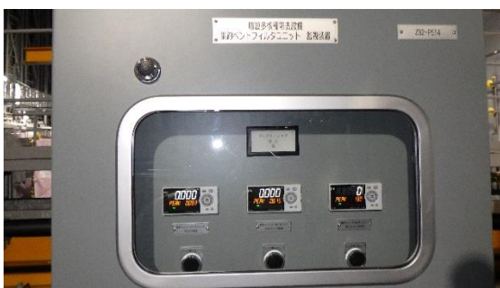
(写真 2 - 1) 常時監視設備の状況
