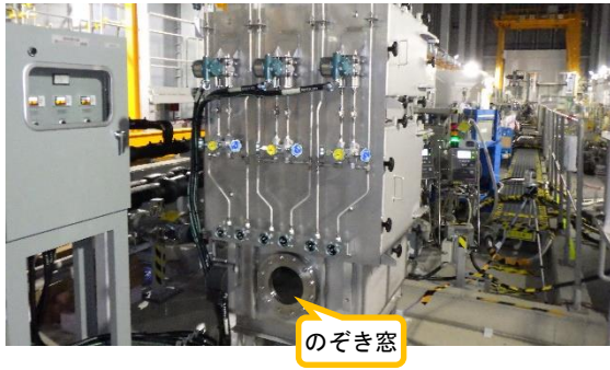
(写真2-2) フィルタに設置されているのぞき窓の状況
