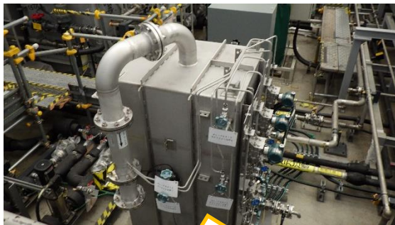
(写真4-1) 既設多核種除去設備内に設置している改良型HIC排気フィルタの状況
