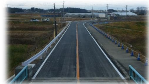
県道母畑須賀川線被災箇所(12月復旧済み)
