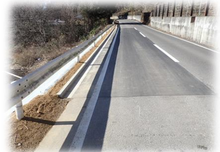
国道118号被災箇所(12月復旧済み)
