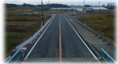
県道母畑須賀川線復旧箇所
