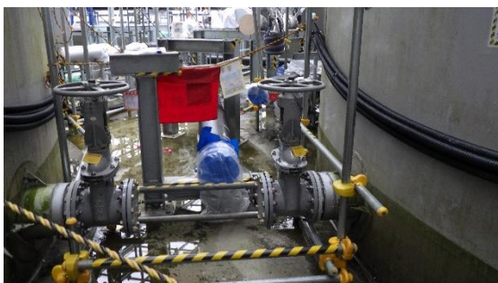
(写真4-3) 連結配管の状況 (取り外されている) ③
