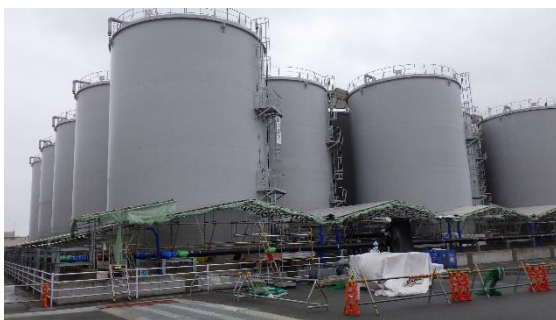
(写真1) K4タンクエリアの概観
