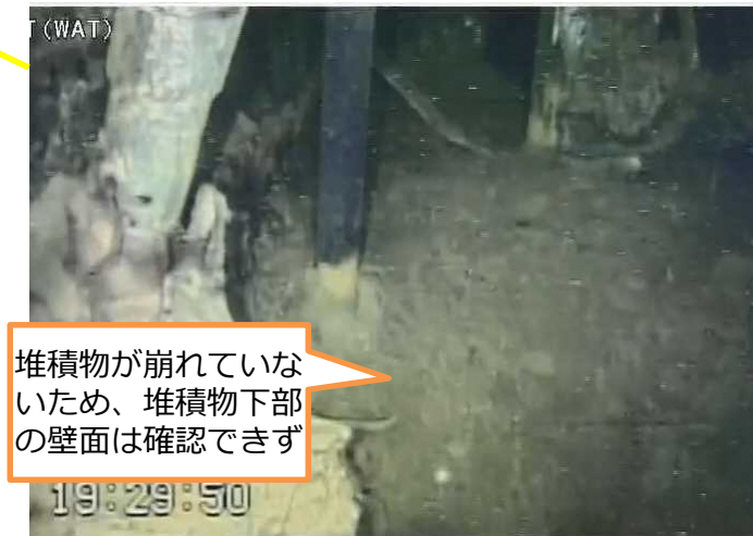
写真6. 遮へい板裏ペDESTAL壁面 (堆積物周辺)
