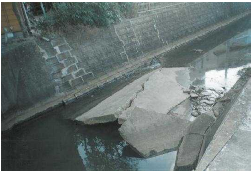
写真2-1 関田ポンプ場(いわき市) 流入渠底板被災状況
