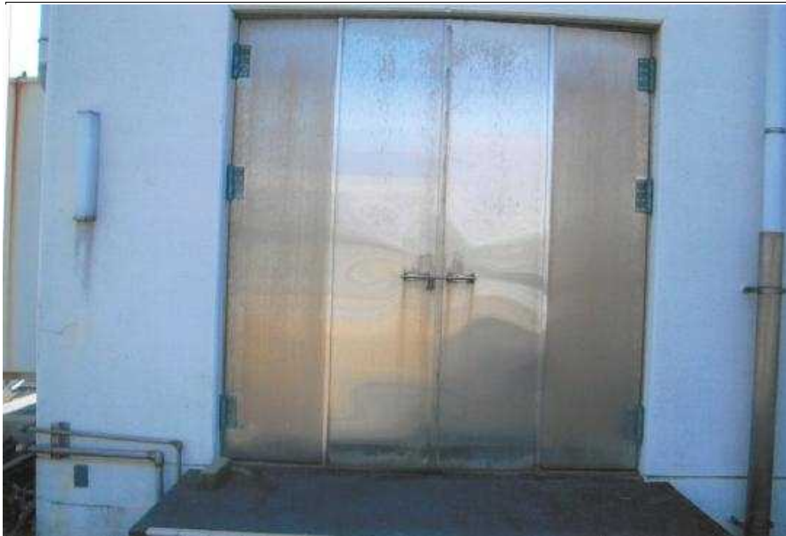
写真1-1 関田ポンプ場(いわき市) 大型引戸門扉被災状況
