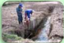
遊休農地の発生状況や施設の劣化状況等の確認
