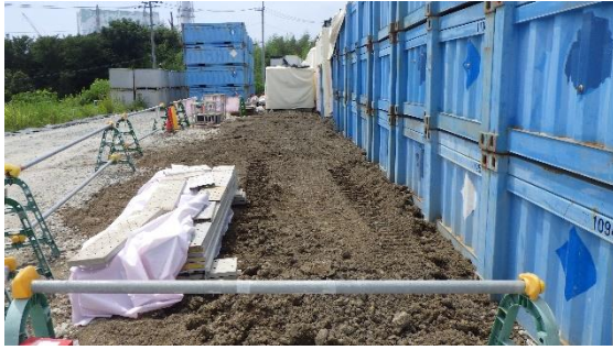
(写真1-4) ノッチタンクが設置されていた箇所の状況 (令和4年8月9日北側から撮影)
