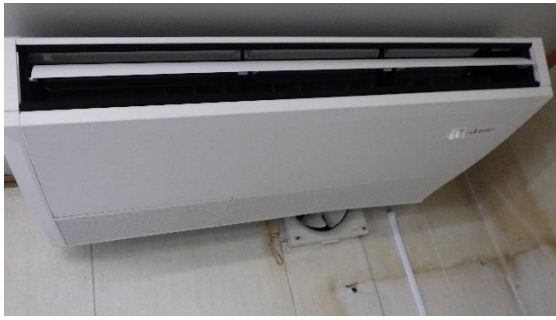
(写真 2 - 1) 水槽のある室内に設置されているエアコン
