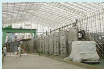
ALPS (建屋内) 吸着塔
