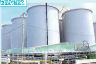
ALPS処理水を保管するタンク
