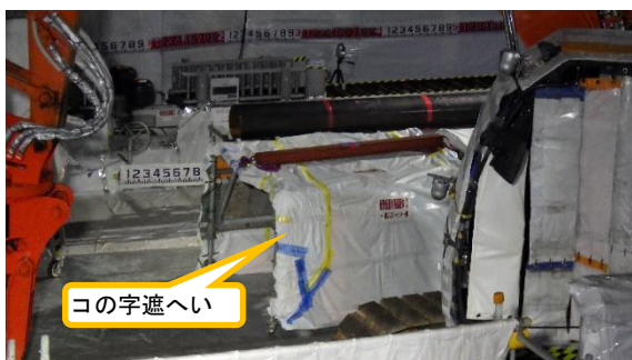
(写真2-2) コの字遮へいの状況② (写真2-1 ともものとは異なる。)
