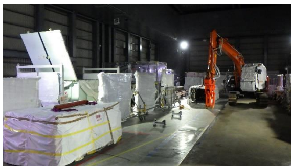
(写真1) 4号機カバー内1階の状況
