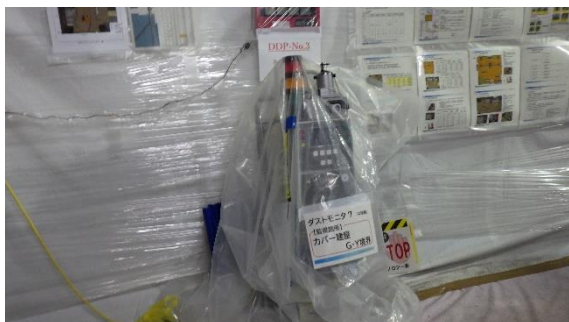
(写真4) ダストモニタの状況
