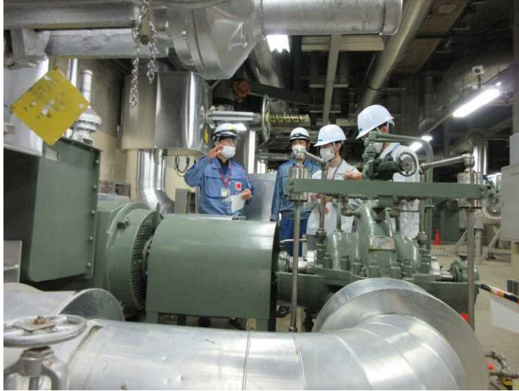
振動が確認され停止した冷却ポンプを確認する県職員（右側2名）
