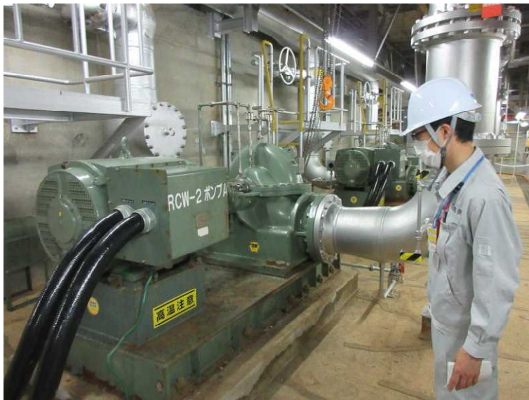
点検停止中の冷却ポンプの復旧の進捗状況を確認する県職員
