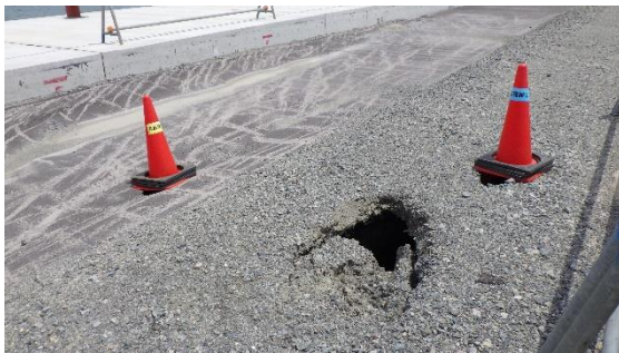
(写真4-2) 新設港湾ヤードの舗装の沈降状況 (南西側から撮影)
