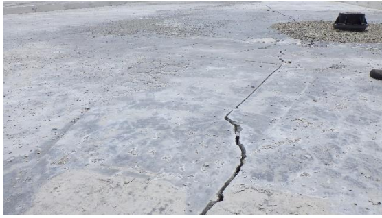
(写真4-4) メガフロート上の盛土した箇所の地 割れの状況 (北側から撮影)
