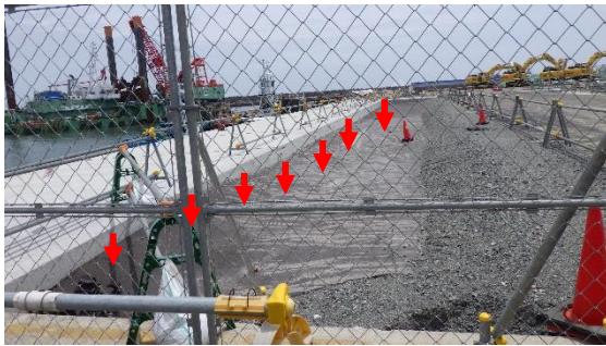
(写真4-1) 新設港湾ヤードの地盤沈下の状況 (西側から撮影)
