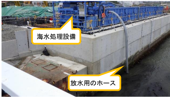
(写真3) 海水処理設備の状況 (南東側から撮影)
