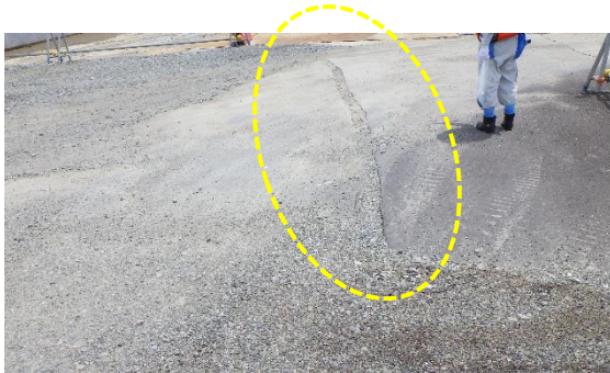
(写真4-3) 新設港湾ヤードの舗装の地割れ箇所の 修繕状況 (西側から撮影)
