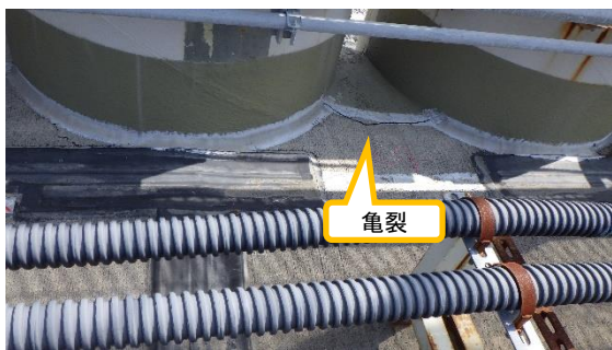
(写真2) 打設されたコンクリートに生じた微 細な亀裂の例
