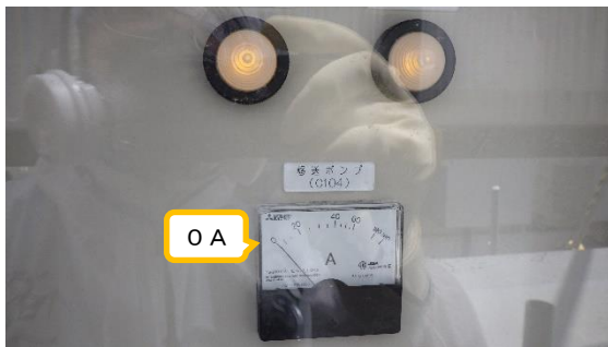
(写真 3-5) 移送ポンプの電力管理用計器 電流が0 Aを示している (ポンプ停止中)
