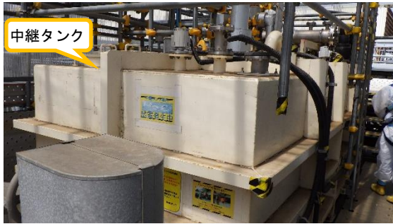
(写真 3-4) サブドレン中継タンクNo. 4の状況
