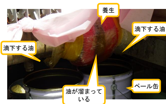
(写真1-2) 漏えい箇所の状況
