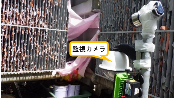
(写真2) 遠隔での監視の状況
