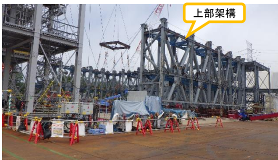
(写真 3 - 1) 上部架構の地組状況① (ヤード中央部を南東側から撮影)
