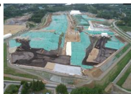
中間貯蔵施設での除去土壌等の安全な保管
