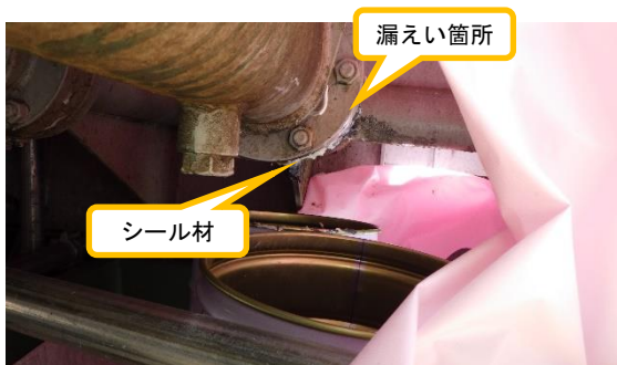
(写真 1 - 2) 接合部油漏えい箇所の防止措置の状況②
