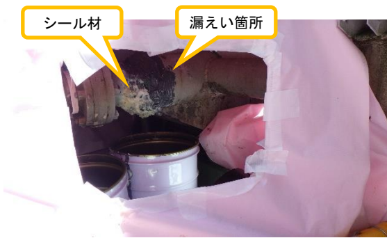
(写真 1 - 1) 接合部油漏えい箇所の防止措置の状況①
