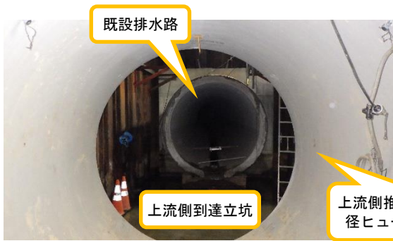
(写真1-3) 上流側到達立坑への到達状況 (上流側推進管(大口徑ヒューム管)内部から撮影)
