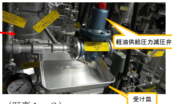
(写真1-2) A系焼却炉バーナーユニット軽油供給圧力減圧弁の状況
