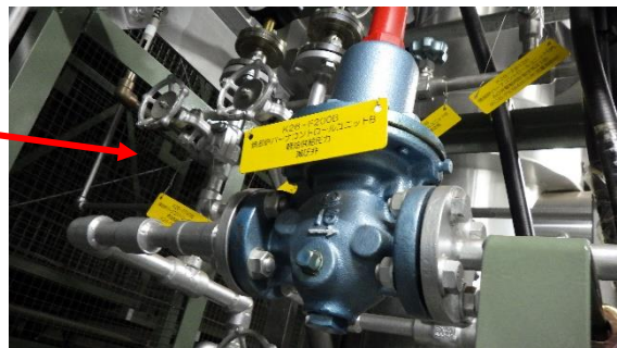
(写真 4 - 2) B系焼却炉バーナーユニット軽油供給 圧力減圧弁の状況
