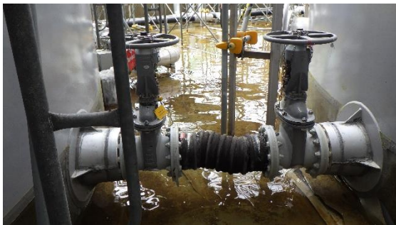
(写真 3 - 2) 連結管の変位の例② (保温材を取り外した連結管)
