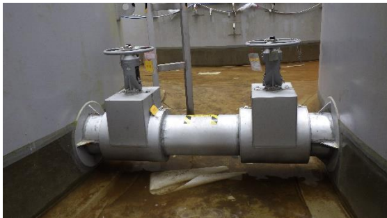
(写真 4) 大きな変位がない連結管の例
