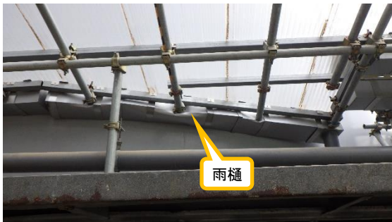
(写真6-1) 雨樋の破損の状況
