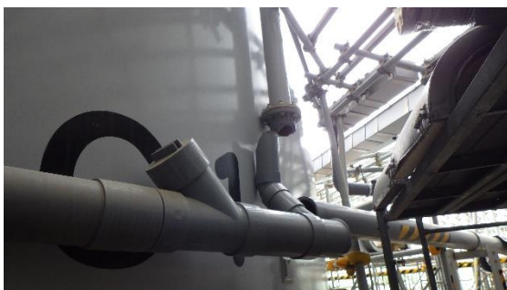
(写真6-2) 雨水排水管の破損の状況
