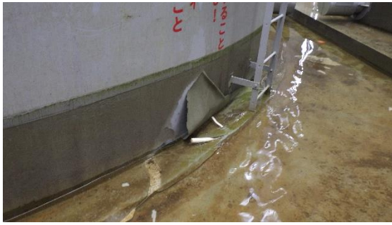
(写真 2 - 1) タンク被覆膜の剥がれの例
