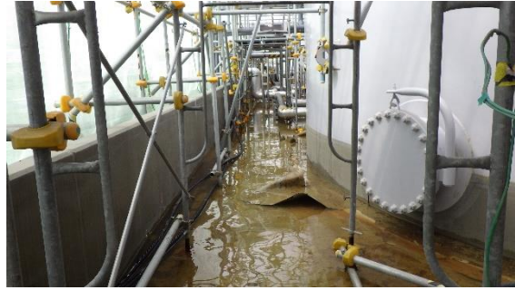
(写真 2 - 2) 堰床面被覆膜の捲れの例
