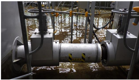
(写真 3 - 1) 連結管の変位の例① (保温材を取り外していない連結管)
