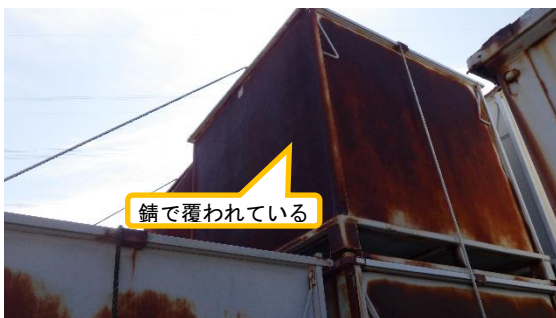
(写真4-1) 劣化コンテナの一例①
