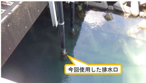
(写真6-2) サブドレン処理水排水口の状況 (異常は確認されなかった。)
