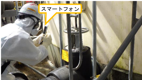
(写真6-1) スマートフォンを用いた排水弁の 確認状況
