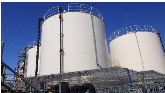
(写真4) サブドレン一時貯水タンクエリアの 外観（南東側から撮影）
