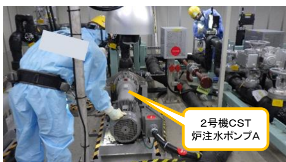
(写真1) 循環運転開始後の点検状況
