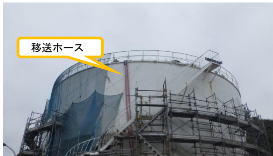
(写真1-1) 移送ホースの接続状況
