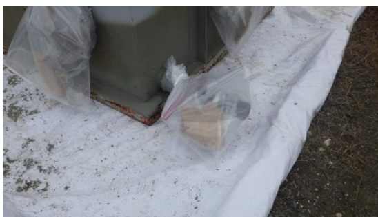
(写真2-2) 移送ホース接続部分拡大 袋養生されている
