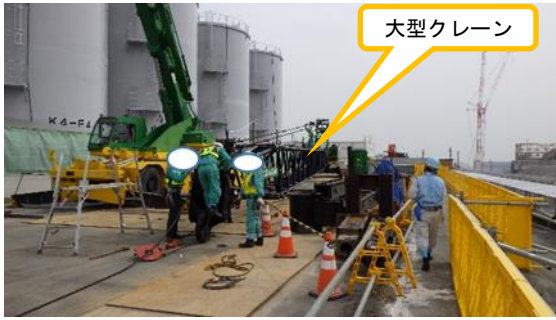
(写真1-1) 両発進立坑設置現場の大型クレーン 組立作業状況
