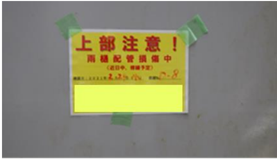
(写真3-2) 雨樋破損に係る注意書き
