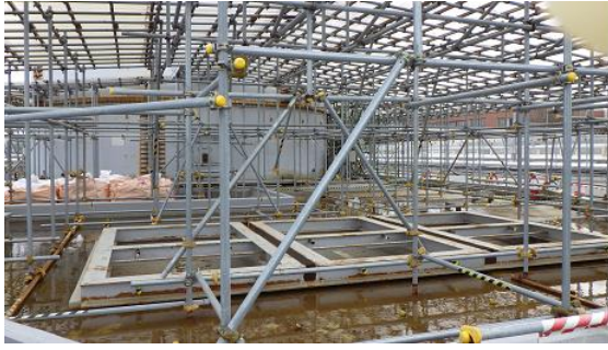
(写真5) 旧処理水バッファタンク堰内の状況
