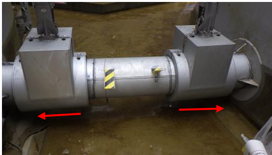
(写真 2 - 3) 位置ずれ（伸び）が最も大きい連結管
